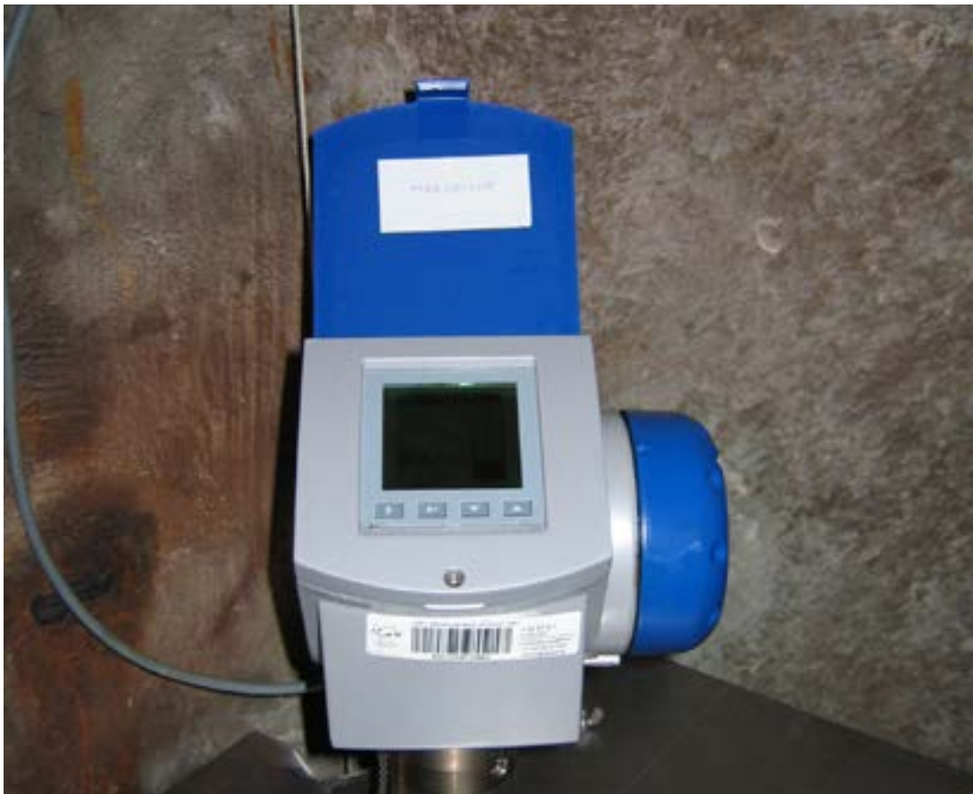
Figure 8 : L'émetteur du marégraphe numérique de l'observatoire de Marseille - © Alain Coulomb
