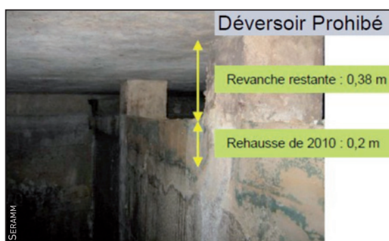
Figure 8. Revanche résiduelle suite à la rehausse sur le déversoir Prohibé
