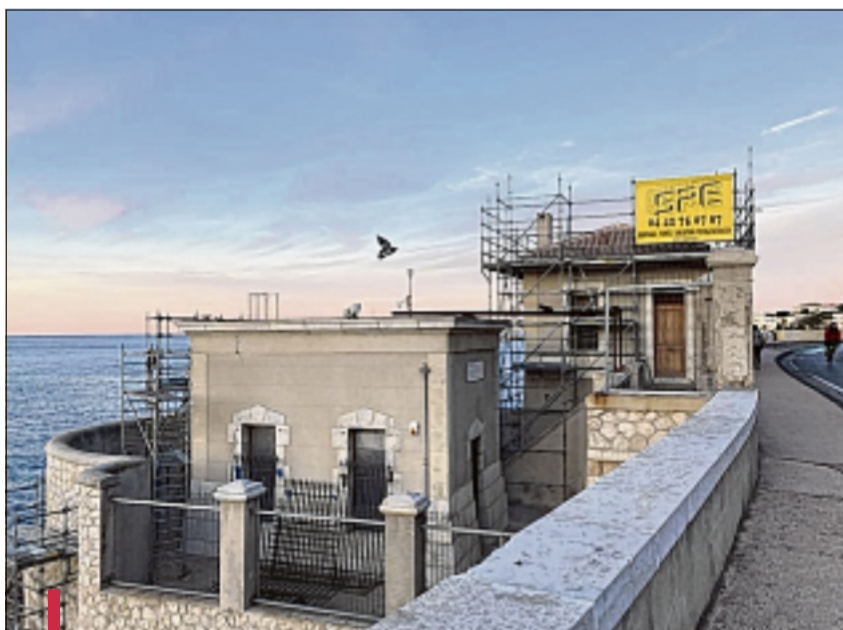
Le chantier, entamé fin octobre, consiste à rénover le bâtiment, sous l'œil d'un architecte expert, le site étant classé monument historique. /PHOTO L.M.
